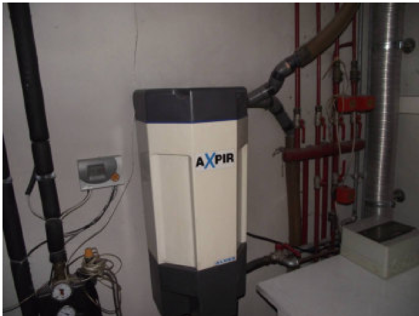
Foto 15 - impianto di aspirazione centralizzato
