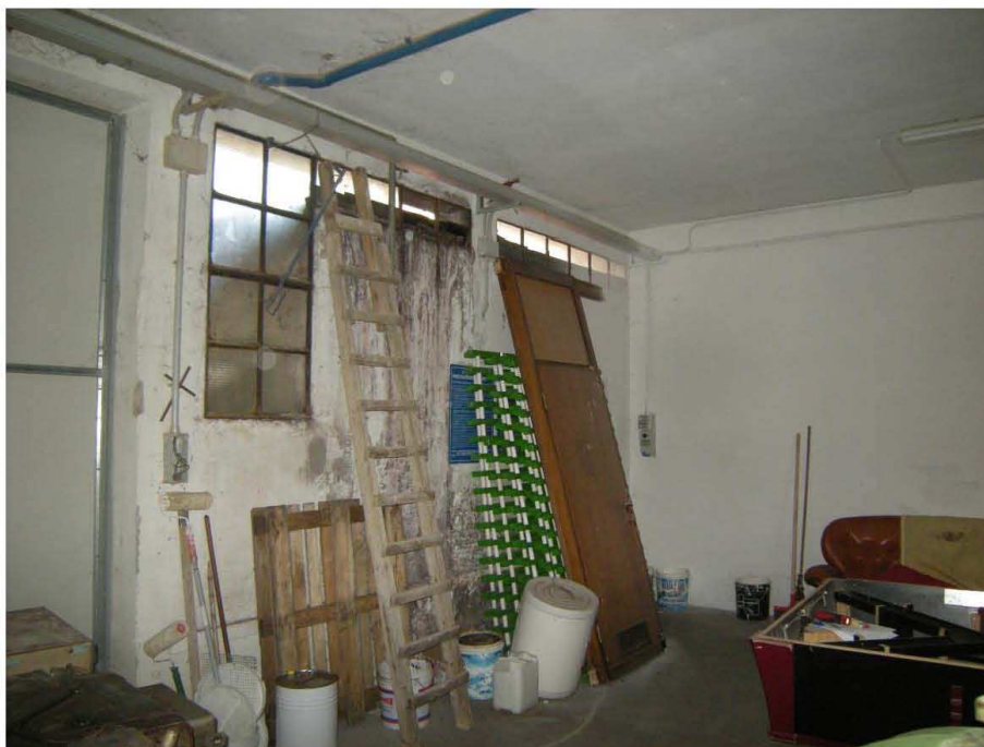
Prata di Pordenone, Particella 629 – La parete sud - ovest del capannone, in basso i danni da infiltrazione di acqua meteorica.
