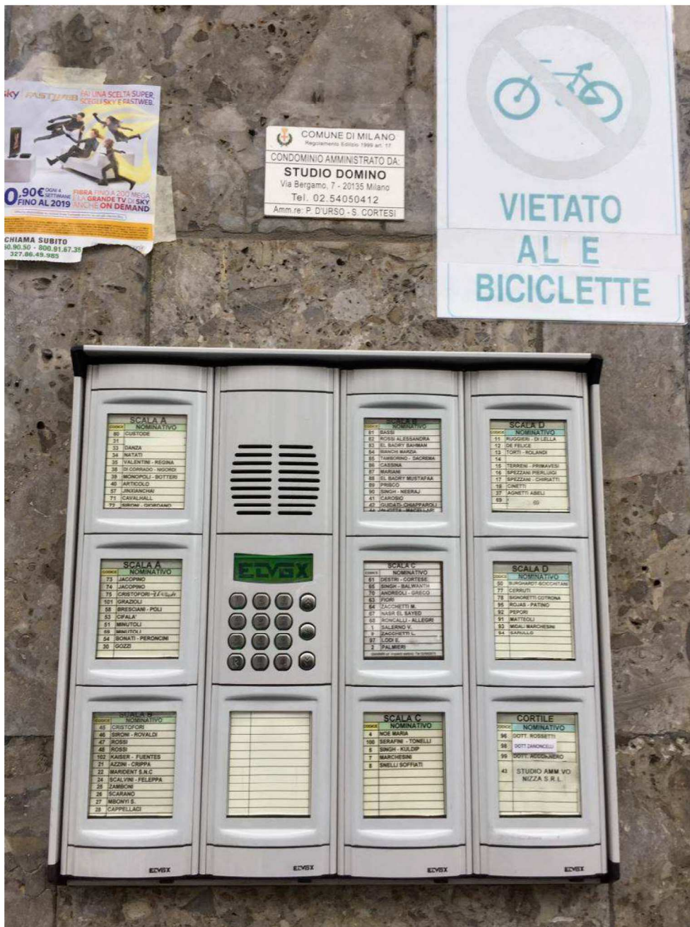
Fotografia n. 5 – Particolare del citofono in corrispondenza del portone di ingresso al Condominio di Via Lessona n. 2, Milano
