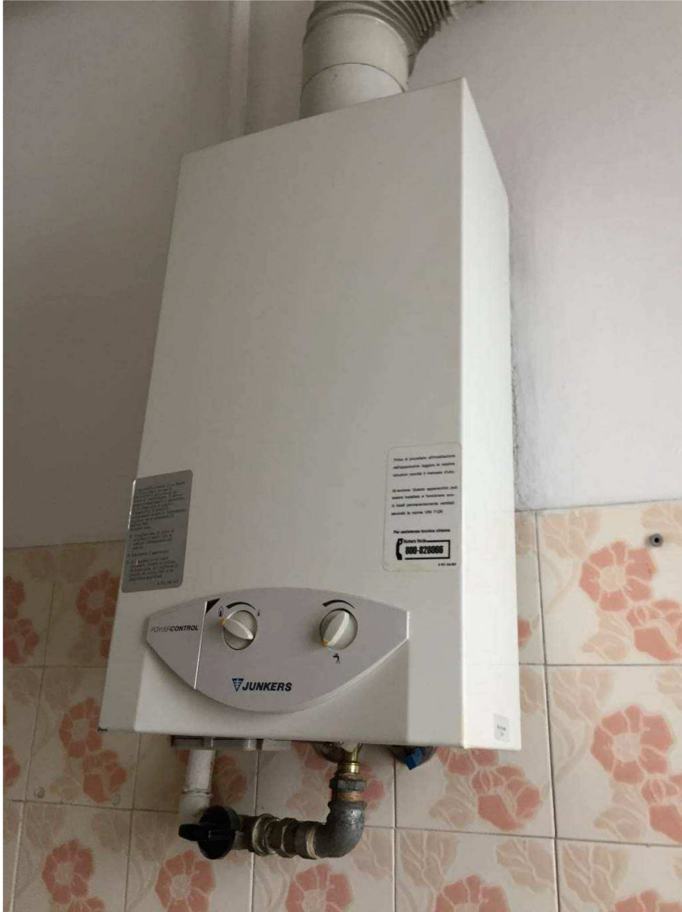
Fotografia n. 26 – Particolare dello scaldabagno posizionato nel locale bagno
