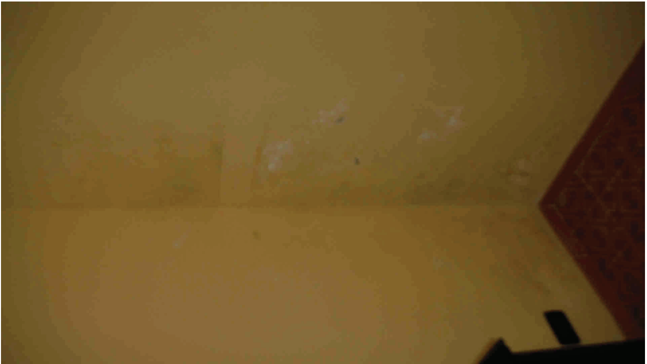
Foto 15 vista dell'interno: fenomeni di condensa .
