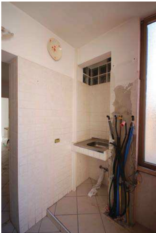
Foto 13_ Interno_Ambito veranda_attacchi caldaia
