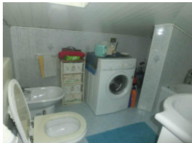
particolare bagno non sanabile al secondo piano
