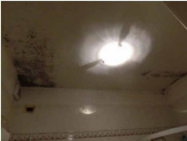
particolare muffa in bagno
