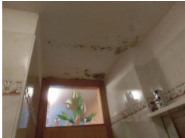
ulteriore particolare muffa in bagno
