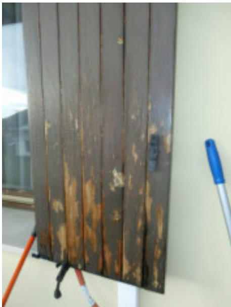
ulteriore particolare balconi da ripristinare
