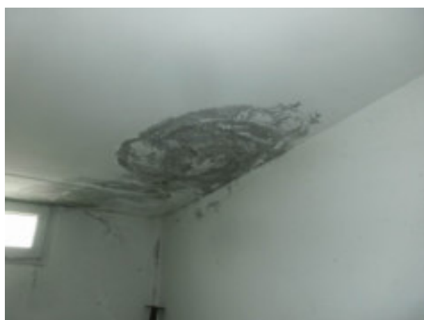
particolare infiltrazione d'acqua nel solaio dell'autorimessa
