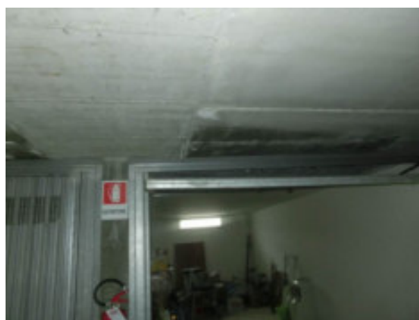
ulteriore particolare di altra infiltrazione nella stessa autorimessa
