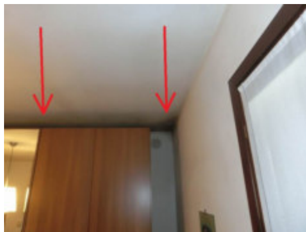
particolare muffa nella camera
