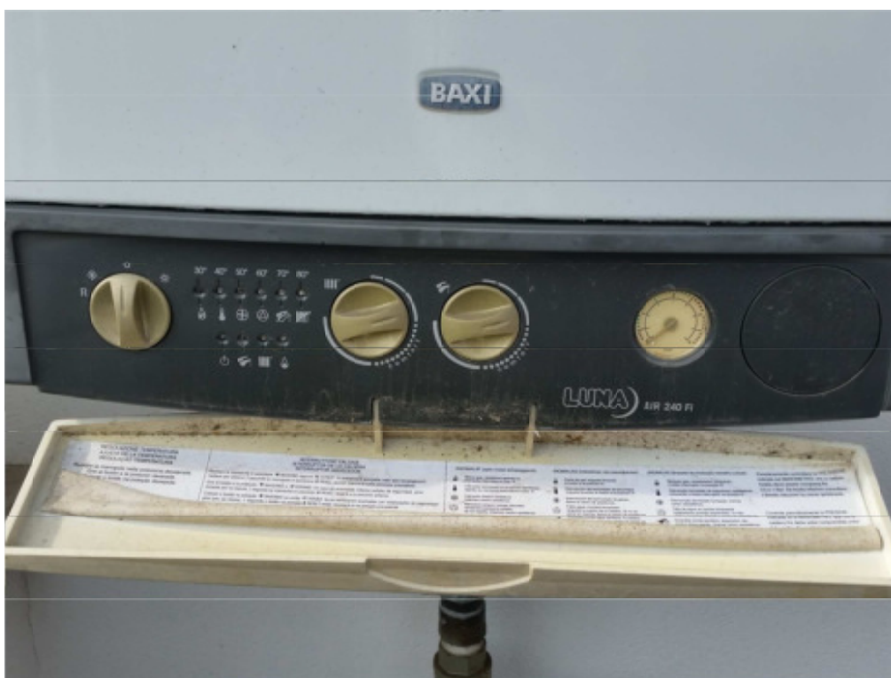
Particolare caldaia presente nella terrazza
