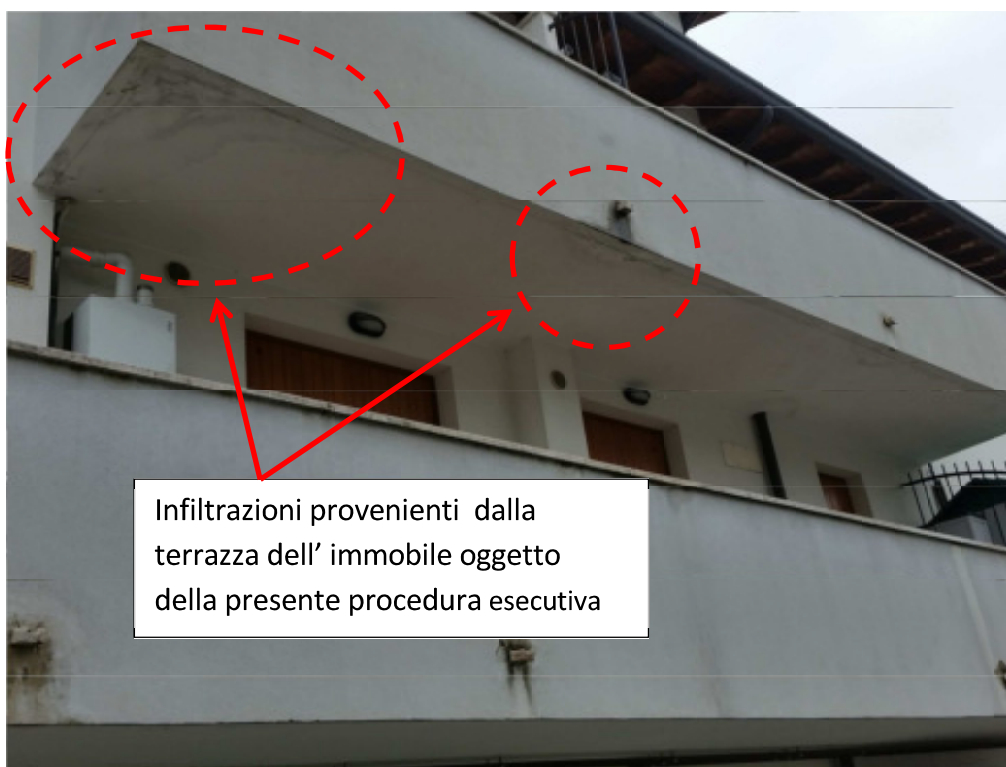
Problematiche di infiltrazione nella parte inferiore del terrazzino dell'unità immobiliare oggetto della presente procedura
