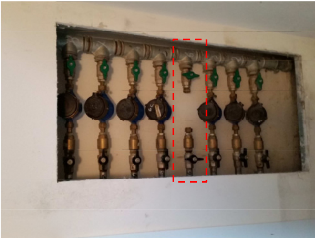
Contatori posti nell'interrato (si noti che non risulta installato il contatore dell'unità immobiliare oggetto della presente procedura esecutiva)
