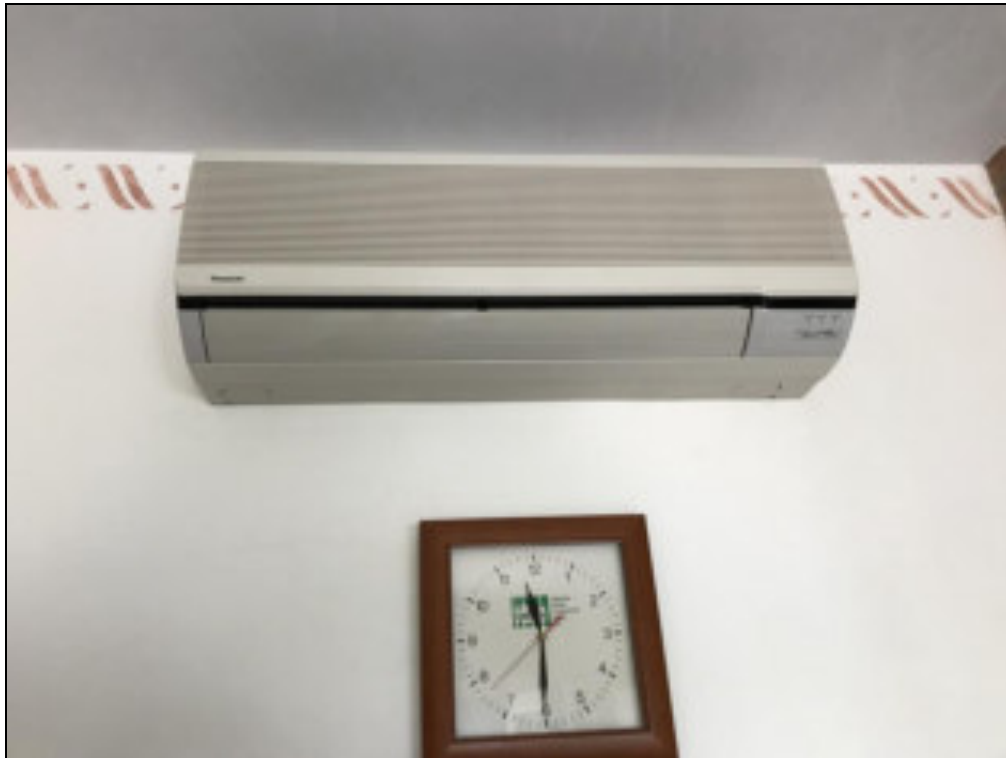
Fig.21: unità di climatizzazione interna
