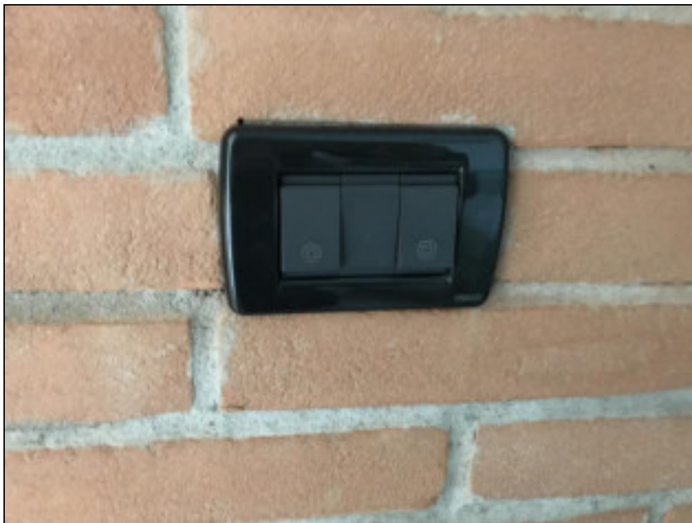
Fig.23: tipologia frutti impianto elettrico
