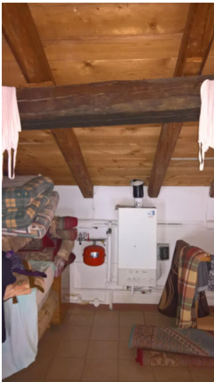
Foto n. 19 – Comune di Vivaro (PN), Foglio 19, particella n°93 sub 16 – Caldaia posta nella soffitta, al secondo piano dell'abitazione.
