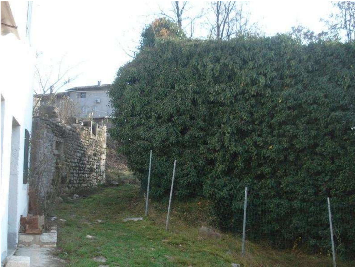
39) Vedute del fronte nord-ovest, interamente ricoperto da vegetazione
