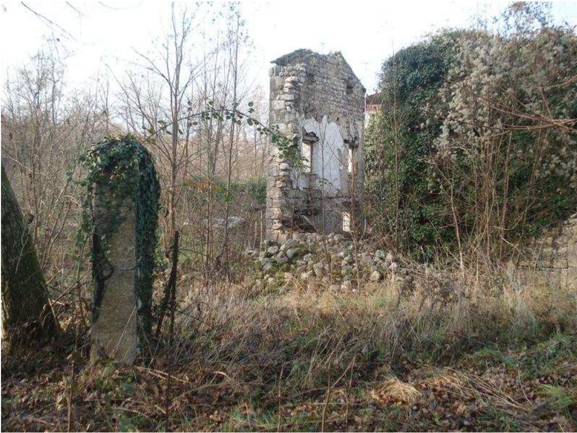
53) Vedute del fronte sud-est parzialmente crollato
