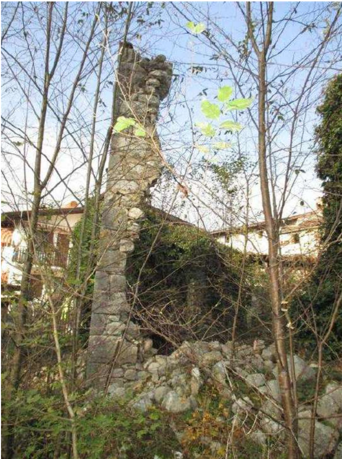
51) Particolare della muratura del fronte sud-est parzialmente crollato
