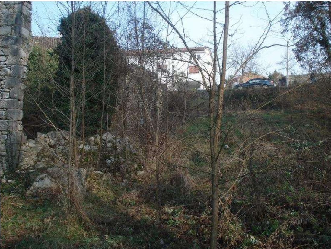
50) Fronte sud-est parzialmente crollato nell'area della ex roggia
