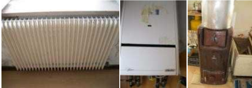
Foto 29-30-31 Dettaglio sistemi di riscaldamento
