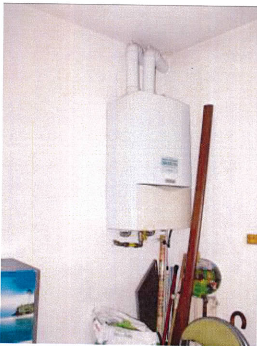
Locale con caldaia autonoma
