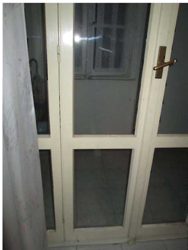
Finestra camera sul corridoio comune chiuso
