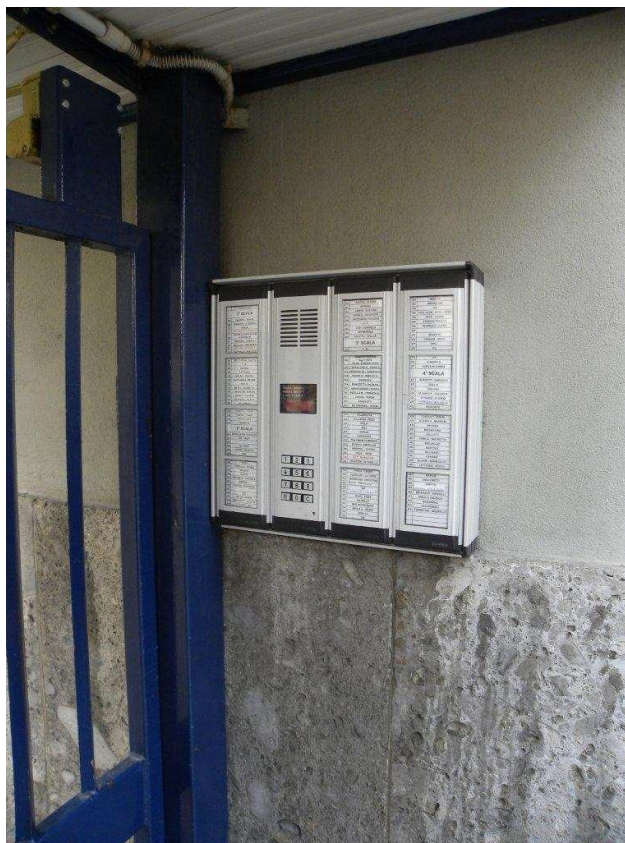
Vista esterna - Citofono
