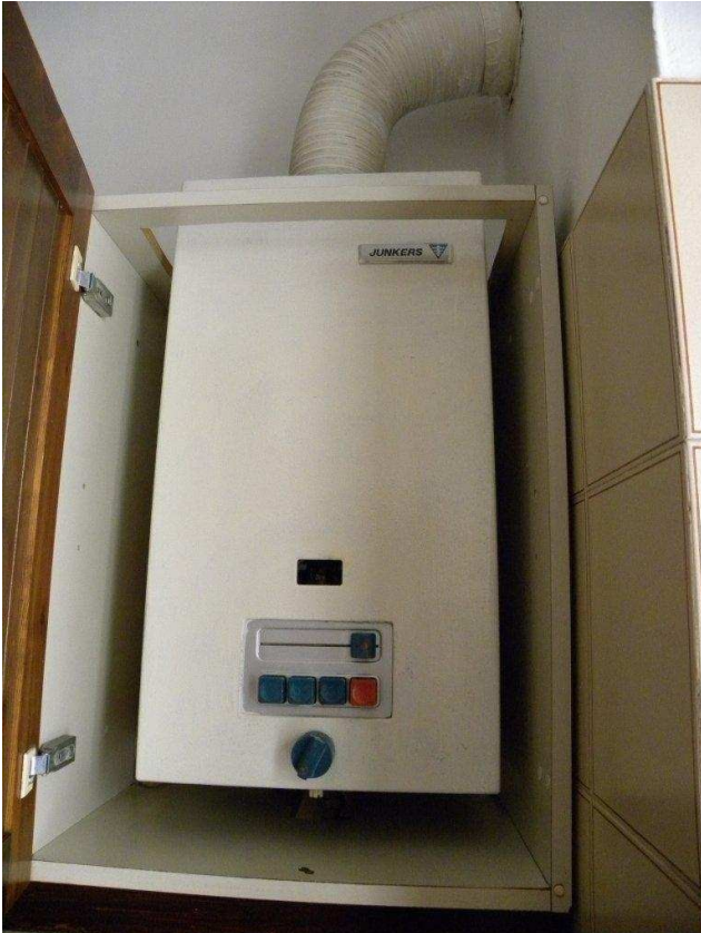
Cucina – Particolare caldaia
