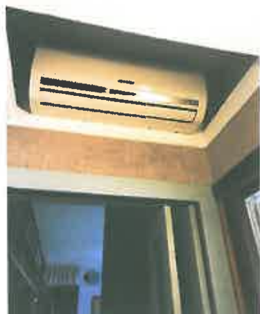
foto n. 21 – erogatore aria condizionata
