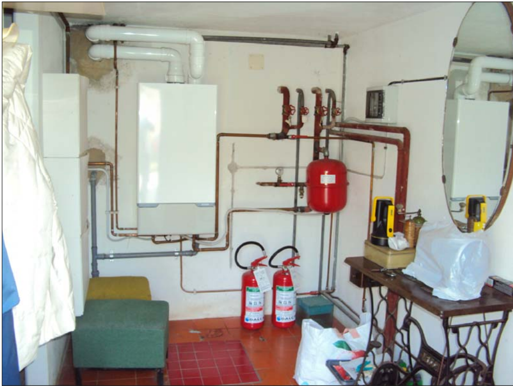
Foto n. 15: Centrale termica (piano seminterrato)
