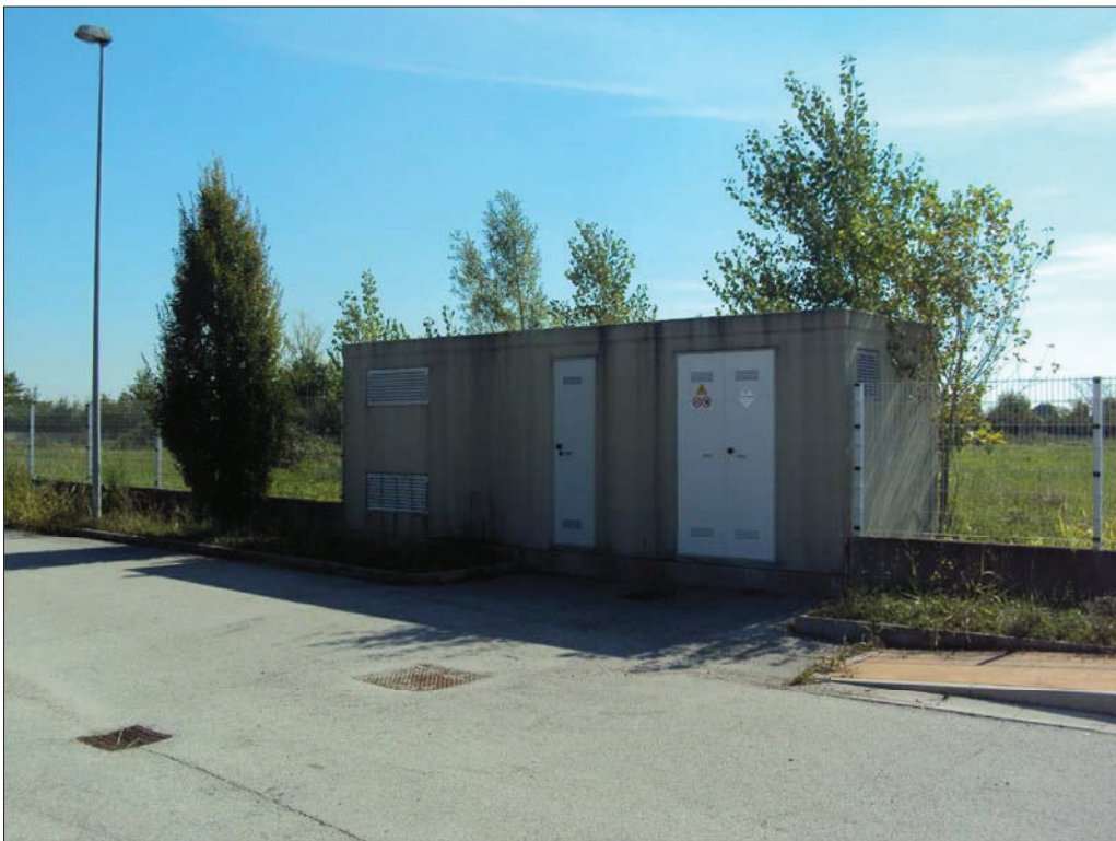
Foto n. 4: La cabina di trasformazione
