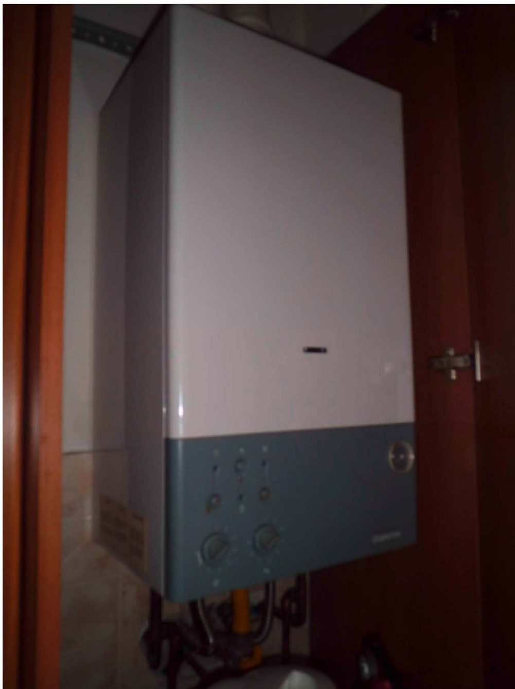
Foto n° 13 - 19/02/2015 - Comune di Pravisdomini - Foglio 11 part. 495 sub.10 - Impianto di riscaldamento: caldaia murale posta all'interno di un armadio nell'angolo cottura del soggiorno.
