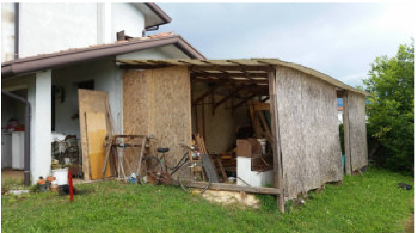
Foto 4 - Tettoia precaria oltre l'ampliamento abusivo
