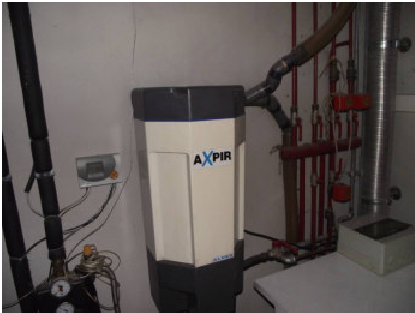
Foto 15 - impianto di aspirazione centralizzato
