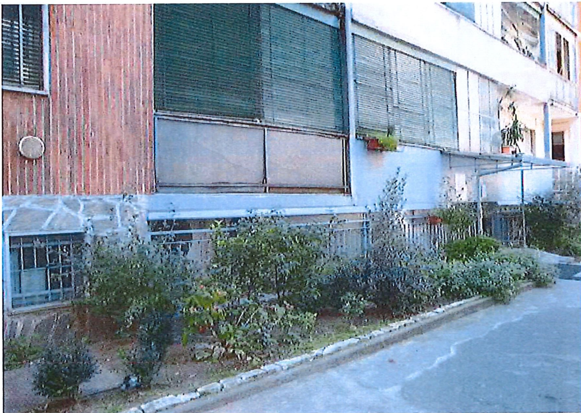
R.G.E. 1057/2017, Dott. Ssa M. G. Mennuni Piolto, Via D. Cimarosa n.°1, scala I, piano rialzato, Foglio 2, mapp. 304, sub. 8 Prospetti esterni: il prospetto sul cortile interno
