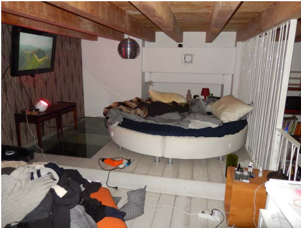
FOTO 15: Interno dell'unità pignorata – Scorcio dell'area soppalcata, la cui irregolarità è determinata sia dal mancato rispetto delle normative in vigore che riguardano le altezze minime, sia dal fatto che la struttura di qua non risulta accompagnata da alcun titolo edilizio abilitativo.
