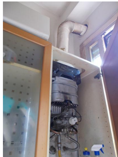
28. Caldaia interna per acqua calda
