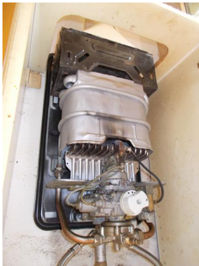
27. Caldaia interna per acqua calda
