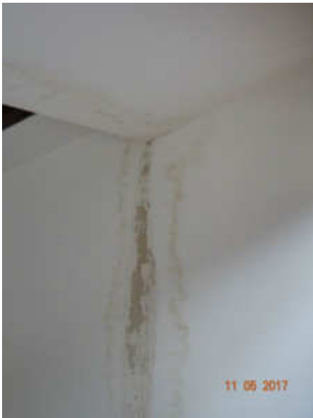
particolare ripostiglio con infiltrazione acqua dal tetto
