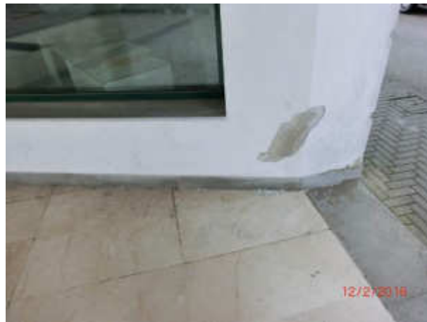
particolare difetti presenti nelle murature del negozio
