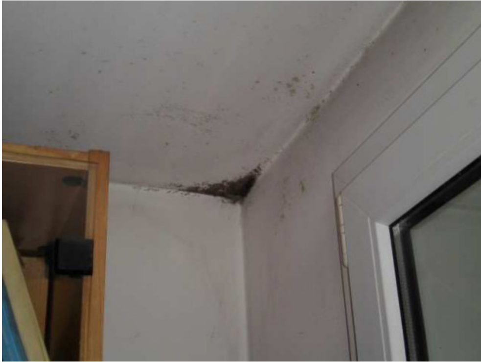
FOTO 23: TRACCE DI UMIDITA' E MUFFA (2° P. – Subalterno n. 32)
