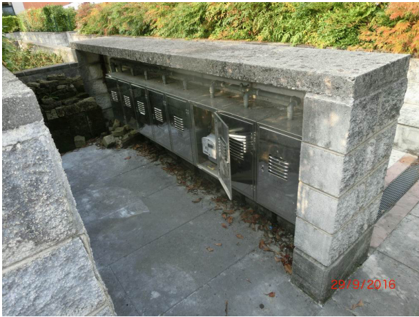
Particolare contatore gas nei passaggi -sub. 58-
