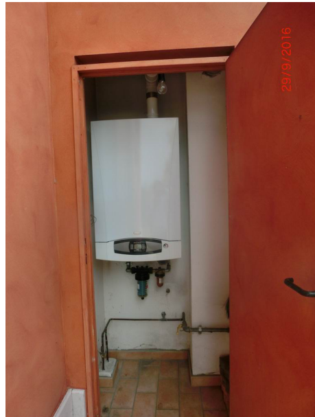
particolare locale centrale termica
