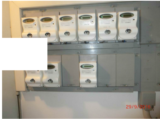
particolare contattore presente nel vano scala -sub. 56 di terzi-
