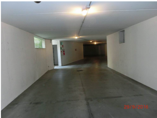
ulteriore particolare del locale comune spazio di manovra -subalterno 57-
