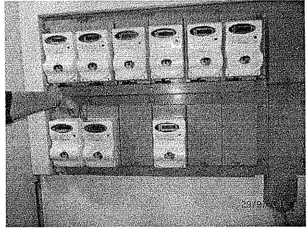
particolare contatore presente nel vano scala -sub. 56 di terzi-
