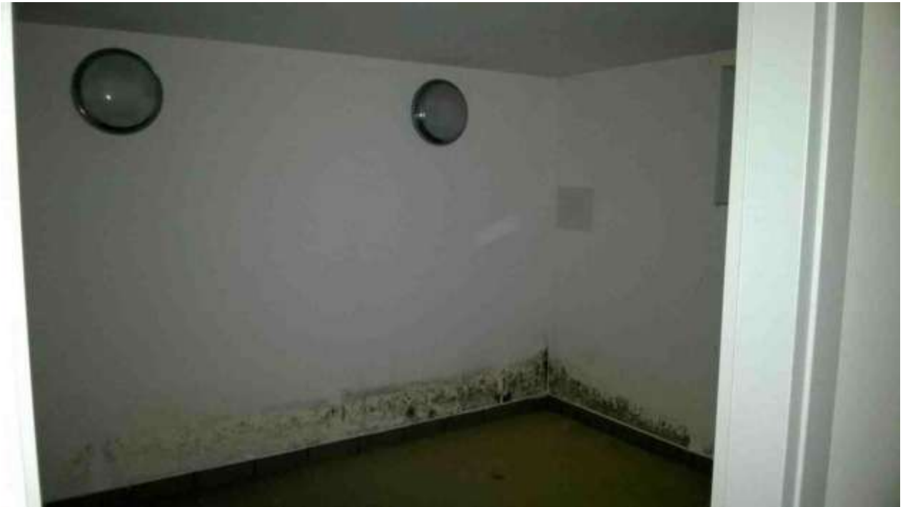
interrato umidità risalita
