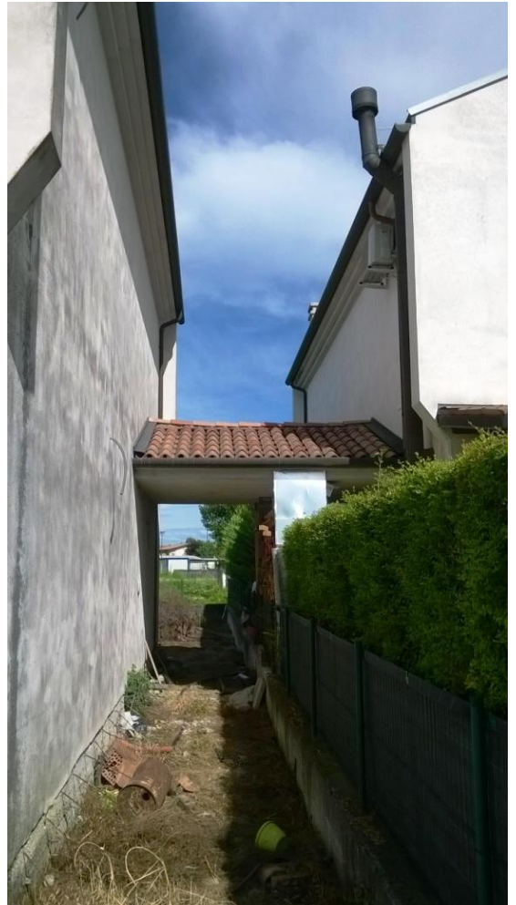
Distacco su confine
