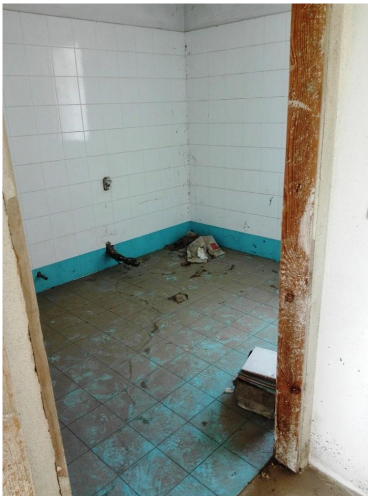
Bagno al piano primo
