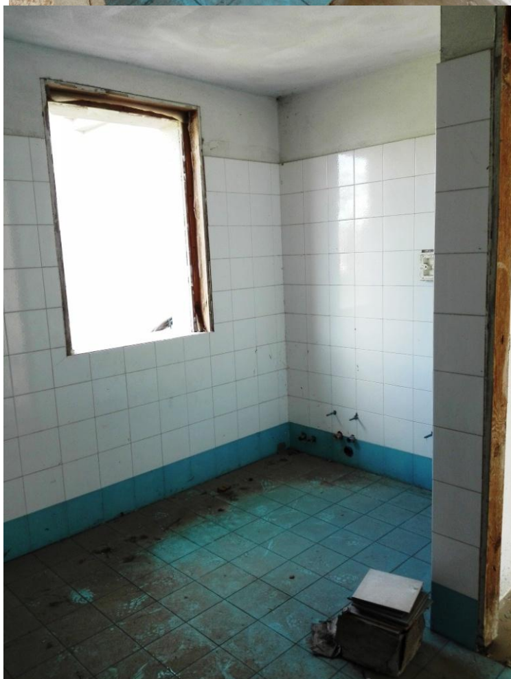
Bagno al piano primo
