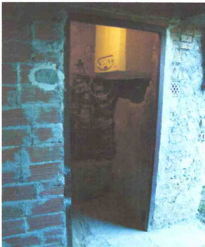
Illustrazione 22: Centrale Termica
