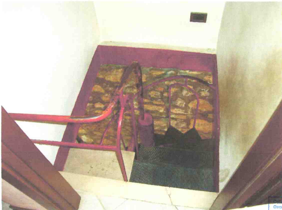
Illustrazione 16: Scala a chiocciola da demolire
