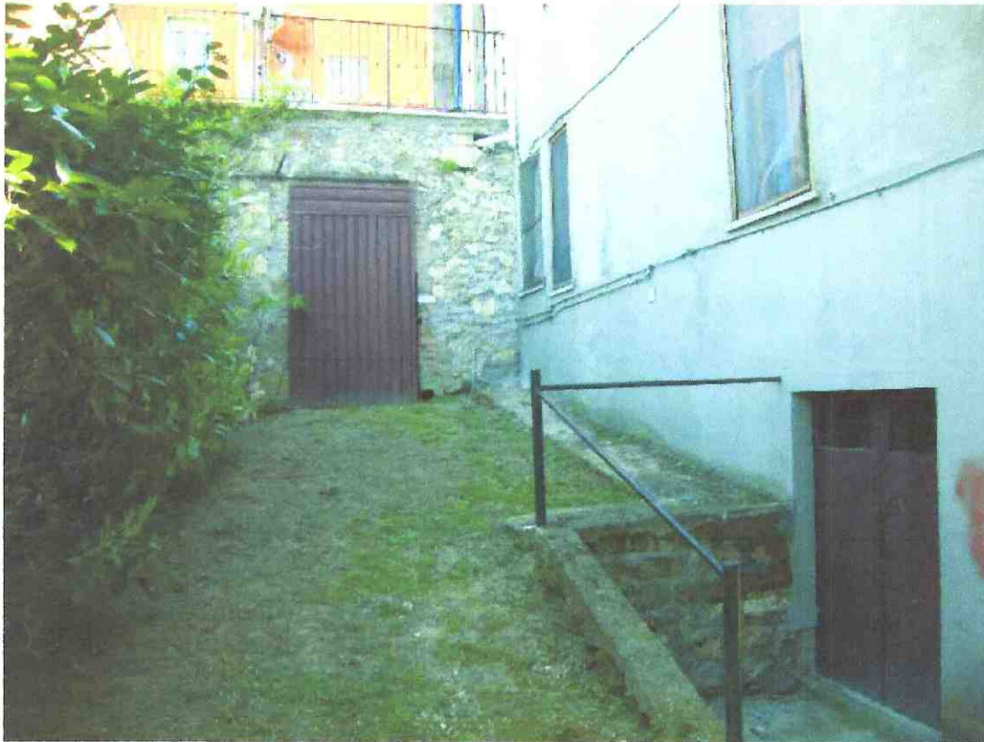
Illustrazione 5: Prospetto lato ovest con in alto particolare ingresso Rimessa e centrale termica in basso ingresso alla dispensa
