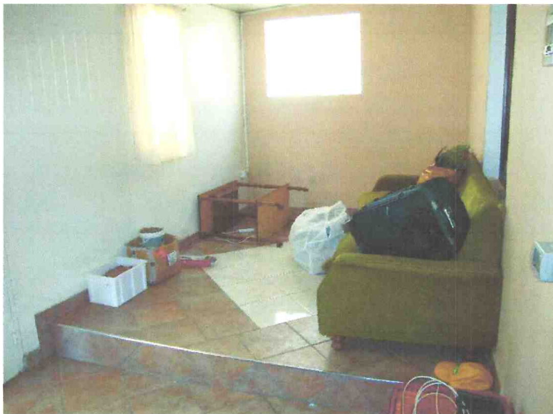
Illustrazione 14: Particolare interno ampliamento abusivamente realizzato
