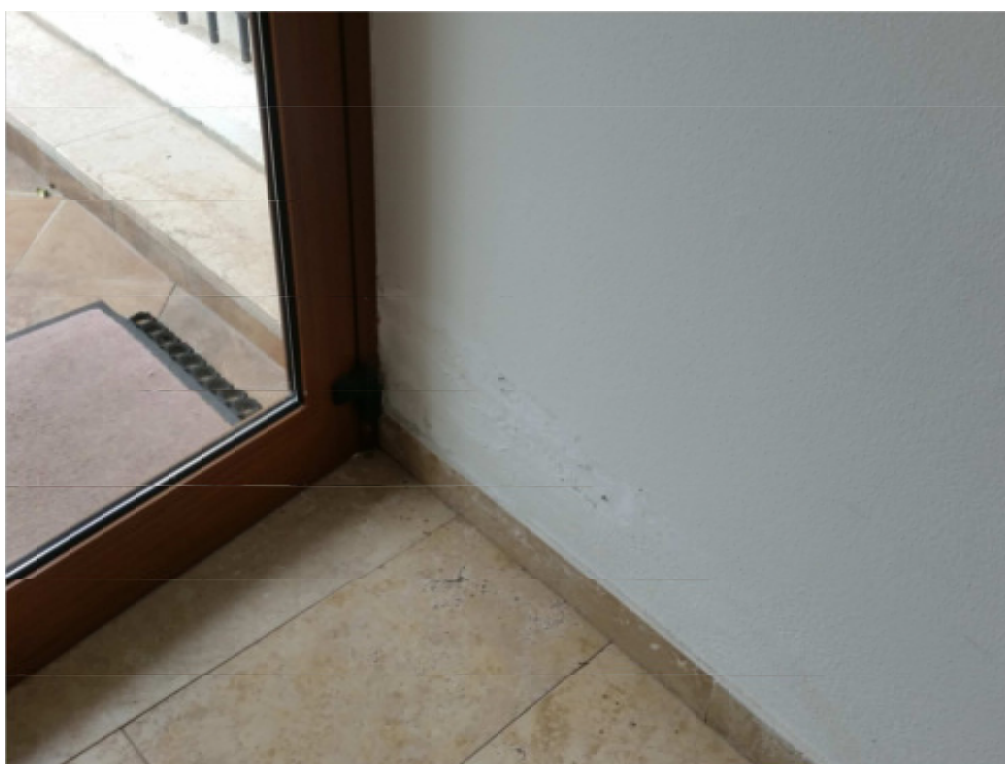
Problematiche di infiltrazione in corrispondenza del portoncino di ingresso al condominio
