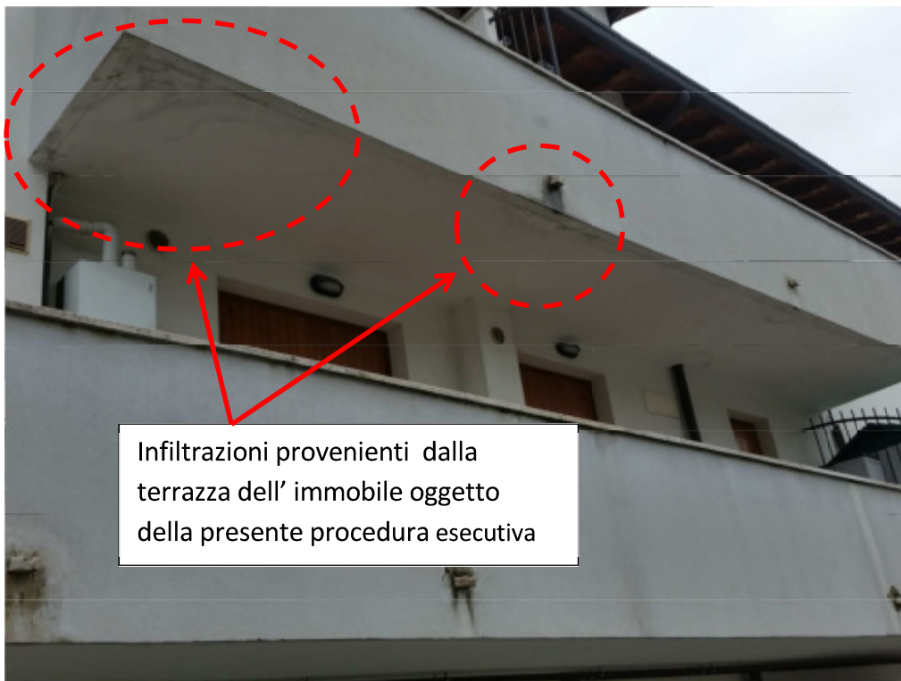
Problematiche di infiltrazione nella parte inferiore del terrazzino dell'unità immobiliare oggetto della presente procedura
