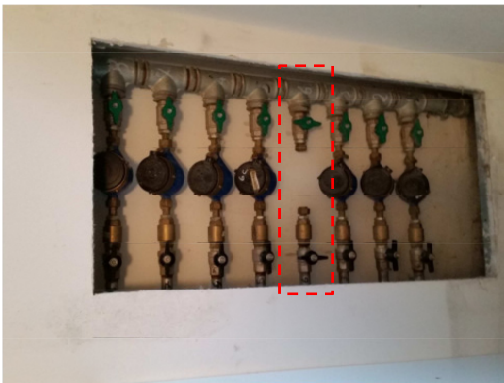
Contatori posti nell'interrato (si noti che non risulta installato il contatore dell'unità immobiliare oggetto della presente procedura esecutiva)
