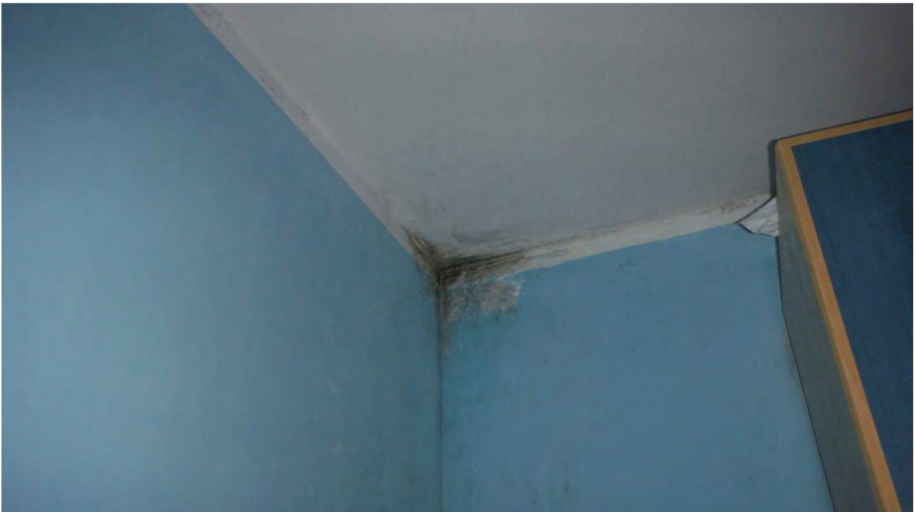
Foto 10 vista dell'interno: fenomeni di condensa nella camera grande.
