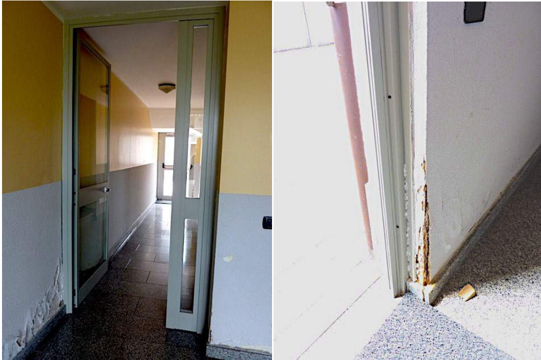
Danni da umidità, per risalita capillare, nelle parti condominiali al piano terra
