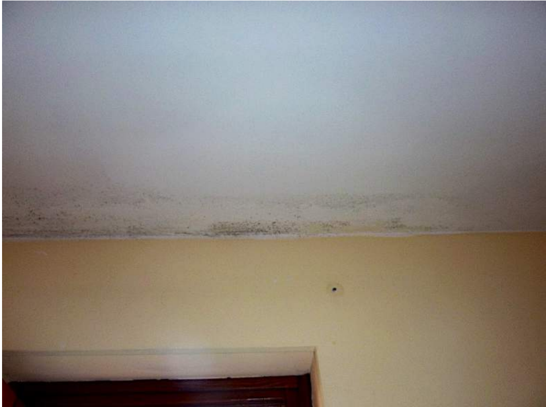
Danni e formazione di condensa e muffe dell'appartamento Lotto 11
