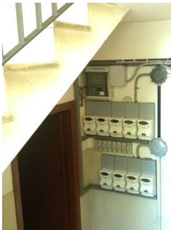
Foto 10. Vista dei contatori elettrici.
