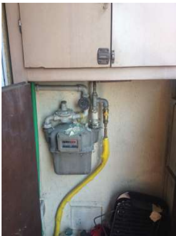
Foto 9. Vista del contatore del gas.
