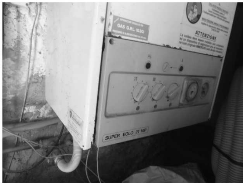
Vista 17 : Caldaia murale posizionata nel locale cantina
