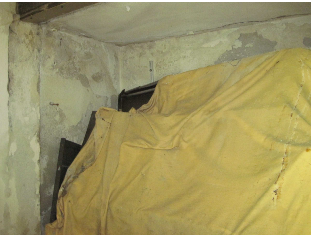
Presenza di muffa ed umidità
