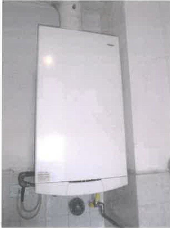
- FOTO 9 - PARTICOLARE CALDAIA MURALE PER RISCALDAMENTO E ACQUA CALDA SANITARIA -
