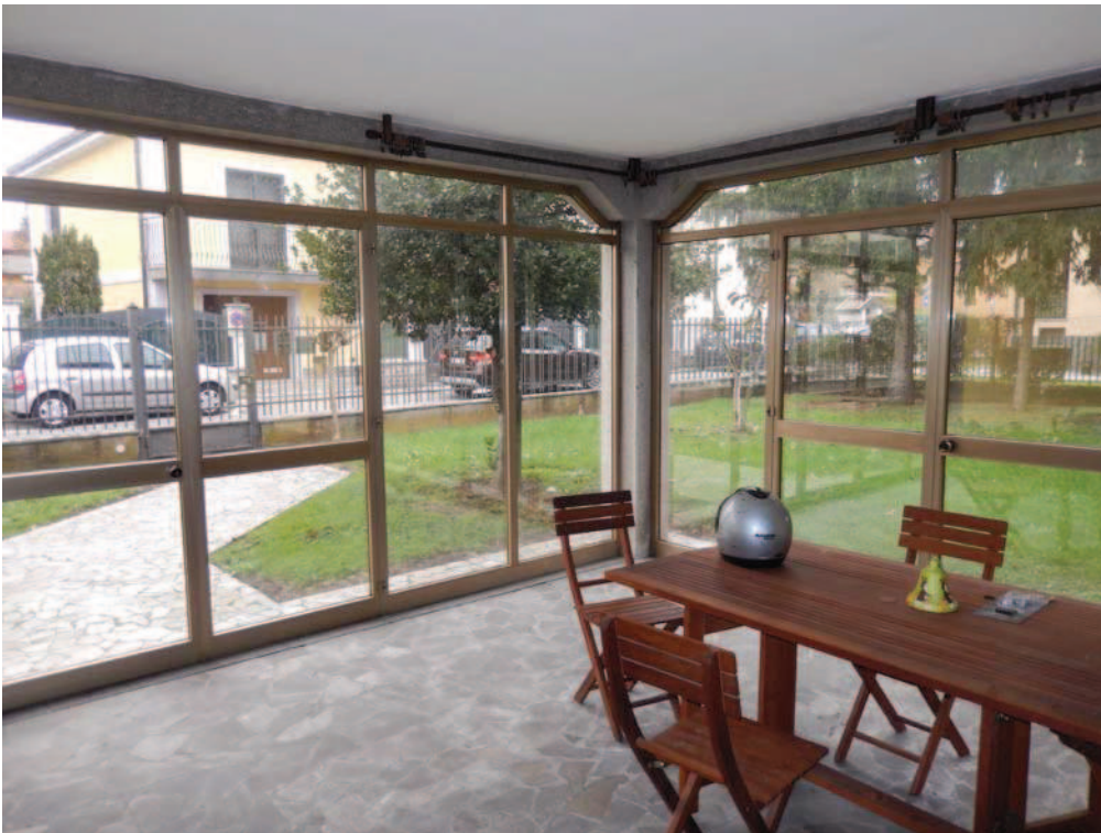
FOTO 4: Scorcio dell'area comune ove è sito l'ingresso all'edificio. Allo stato, l'area è chiusa con serramenti in alluminio e vetro, il che non risulta conforme a quanto previsto dalla pratica edilizia mediante la quale è stato costruito il fabbricato.
