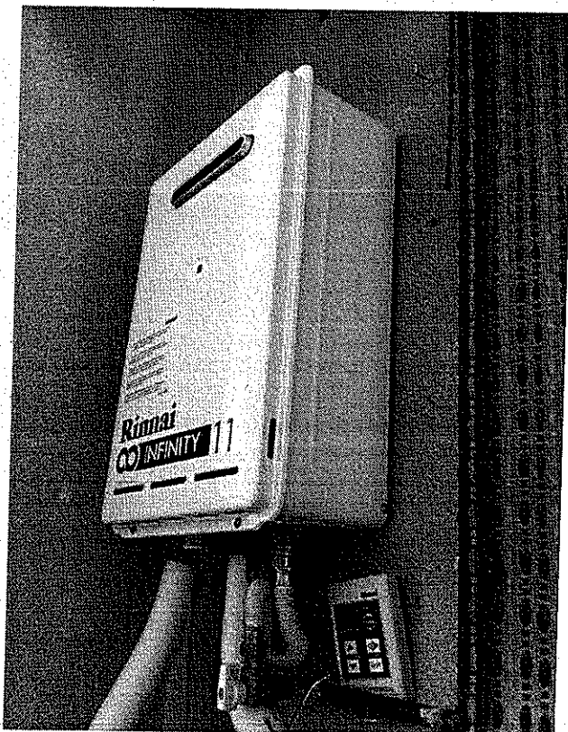
Vista caldaia per ACS sul balcone
