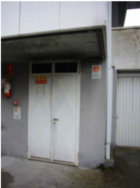
particolare ingresso C.T. comune
