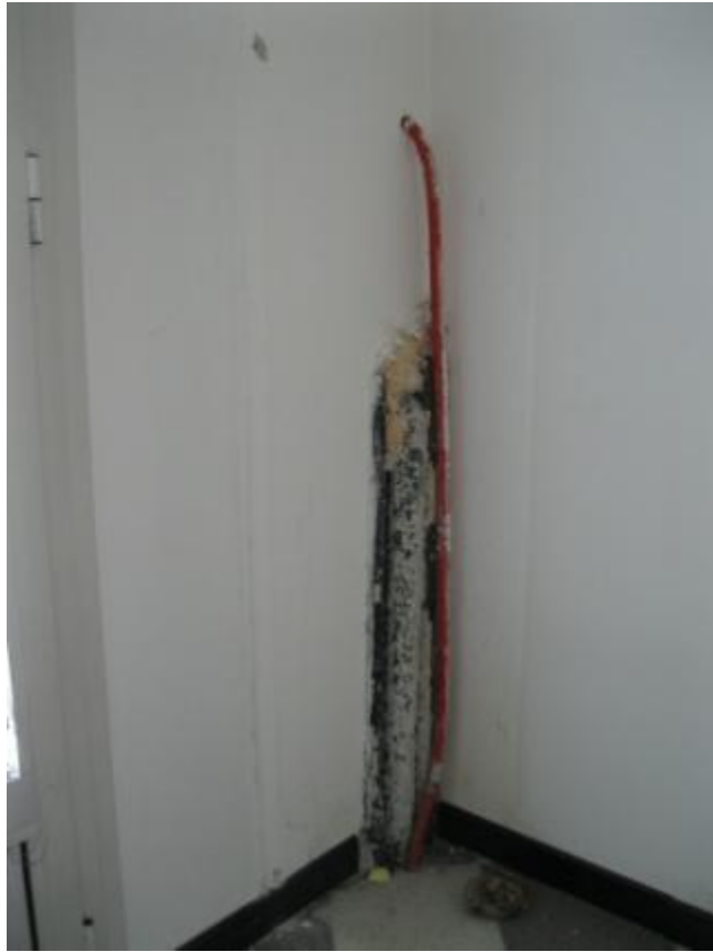
Foto 13 Dettaglio tubatura esposta
