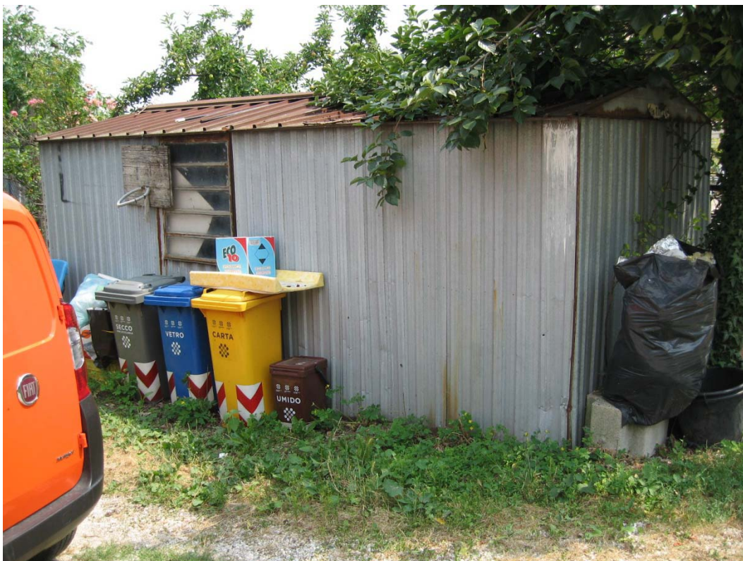
Foto 4: vista baracca provvisoria abusiva da asportare
