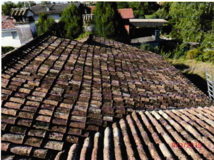
particolare coppi scesi verso la grondaia
