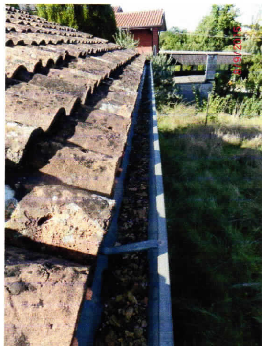
particolare sfaldamento coppi in grondaia
