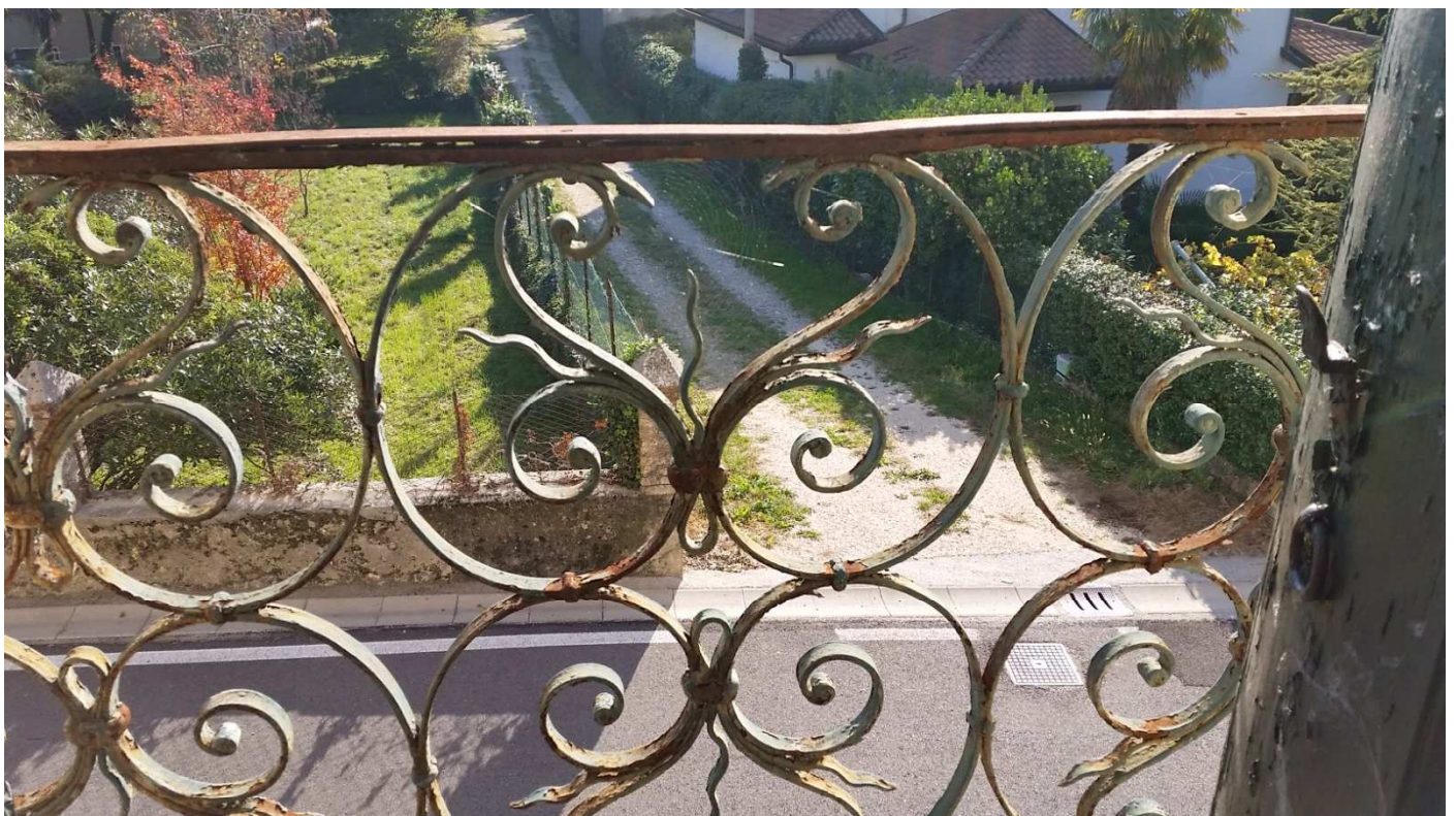
Foto 40 Dettaglio ringhiera poggiolo
