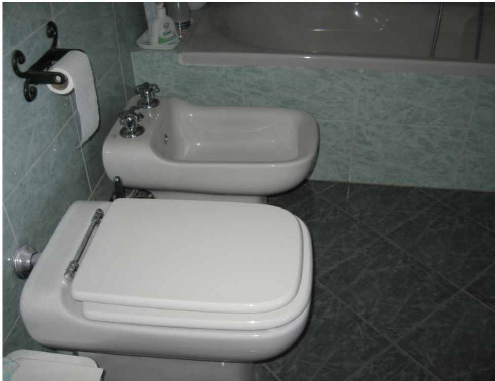
Particolare dei sanitari del bagno al sesto piano
