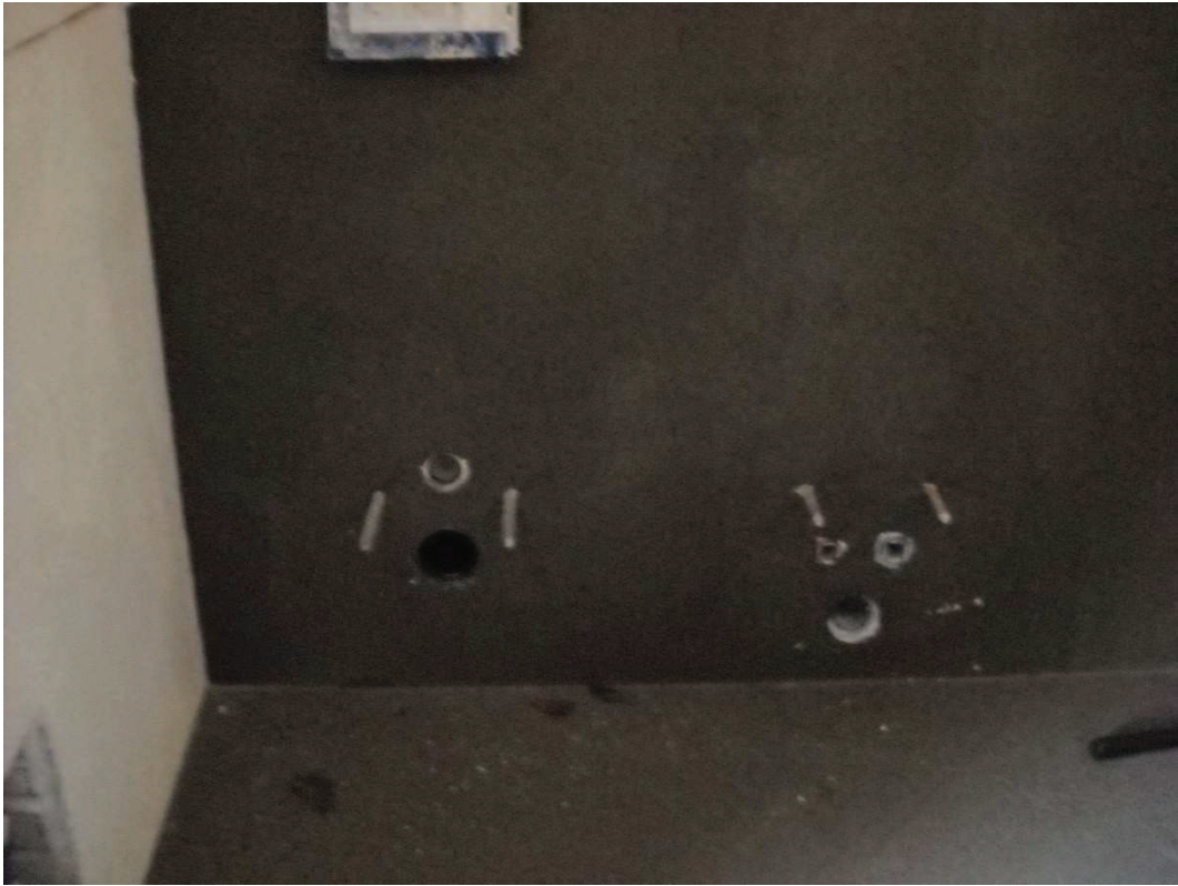
Foto 20 Allacciamenti bagno Piano 1
