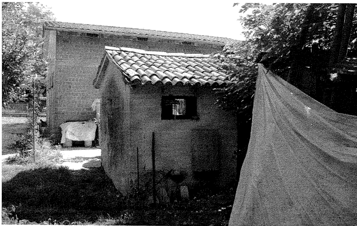
Foto 2.13 – vista da ovest del porcile "B" (abusivo, da demolire)
