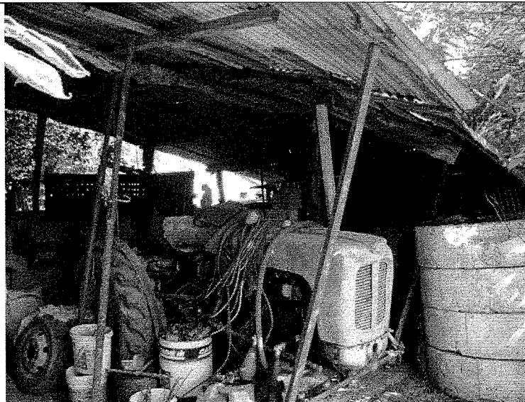
Foto 2.14 – vista della tettoia "C" (abusiva, da demolire)
