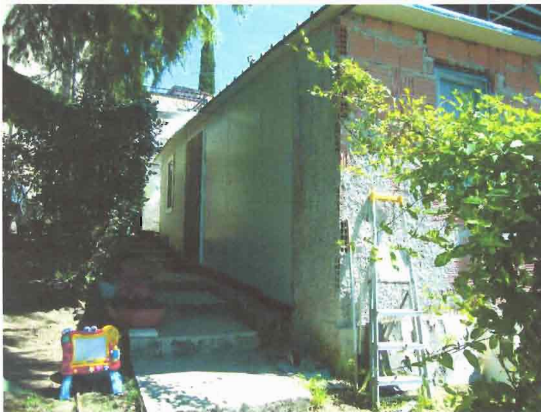
Illustrazione 3: Prospetto lato ovest con particolare ampliamento abusivamente realizzato
