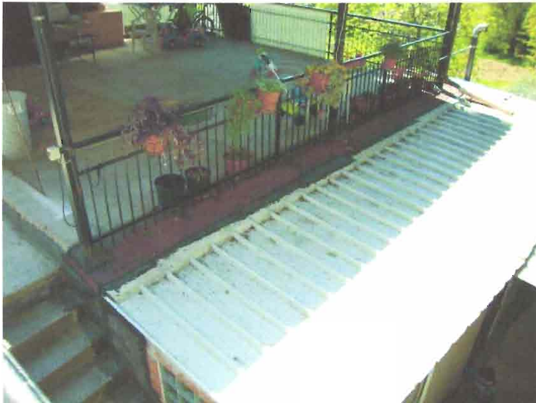
Illustrazione 5: Particolare copertura ampliamento garage abusivamente realizzato
