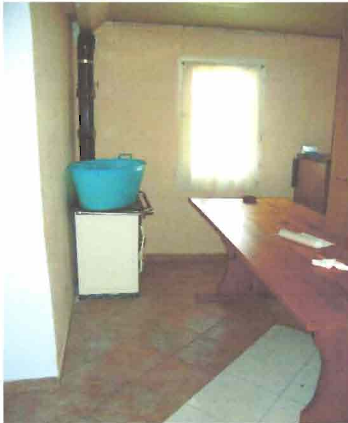
Illustrazione 13: Particolare interno ampliamento abusivamente realizzato
