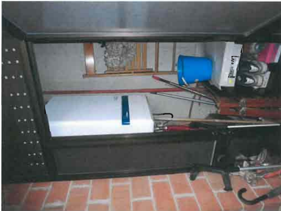
Foto n.16 - Caldaia su Terrazza
